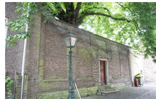
Figuur 6. 2023 Kastanjeboom en de muur met schade. 7
